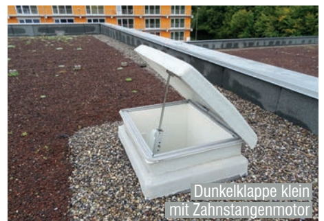
Flachdach mit diversen Dunkelklappen und RWA-Steuerung
